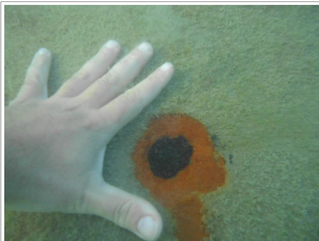
Foto 5: Progressiva 90m – Foro circolare diam. < 5cm dovuto a probabile corrosione galvanica
