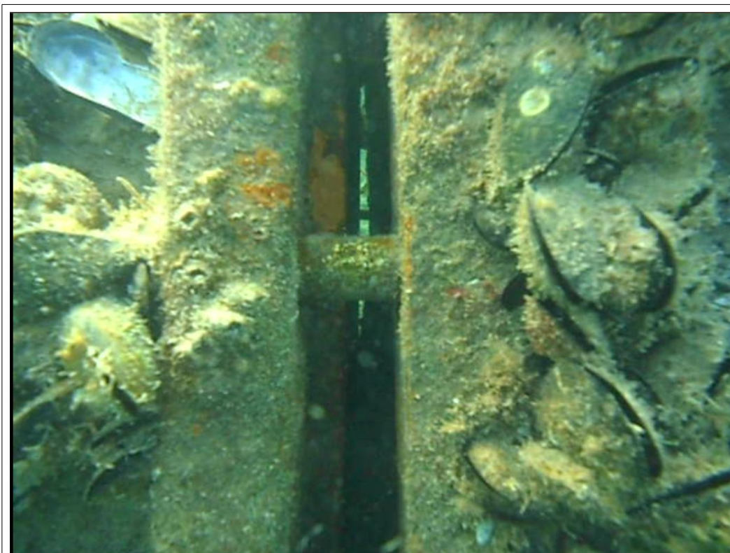
Foto 6: Particolare della flangia di giunzione non perfettamente giuntata
