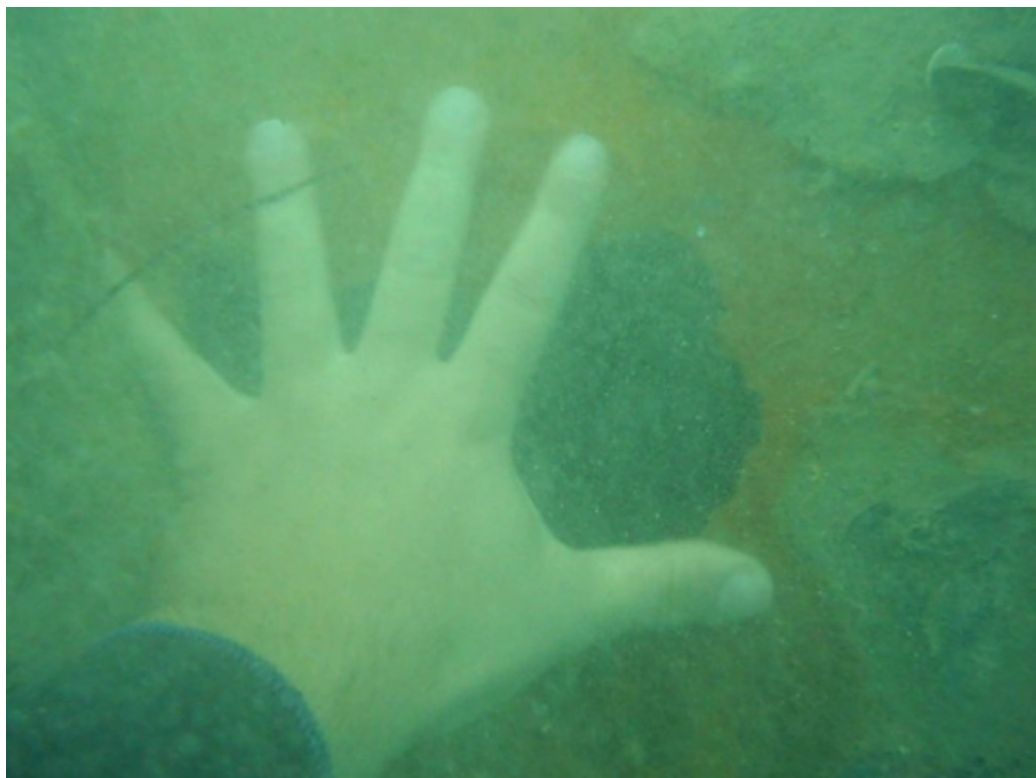
Foto 3: Progressiva 148m – Squarcio di forma irregolare di circa 15/20cm di ampiezza
