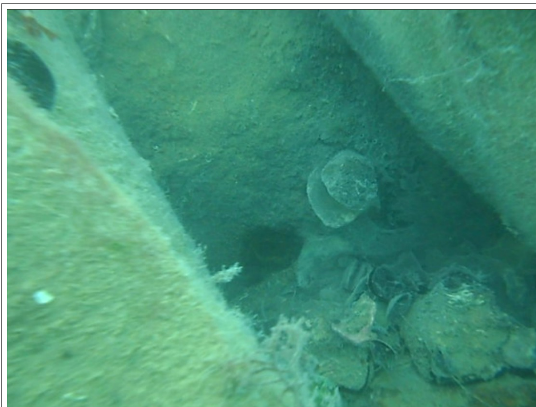
Foto 1: Progressiva 150m - Foro circolare diam. < 3cm dovuto a probabile corrosione galvanica
