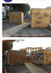
3 CABINE ELETTRICHE PIAZZA REPUBBLICA
